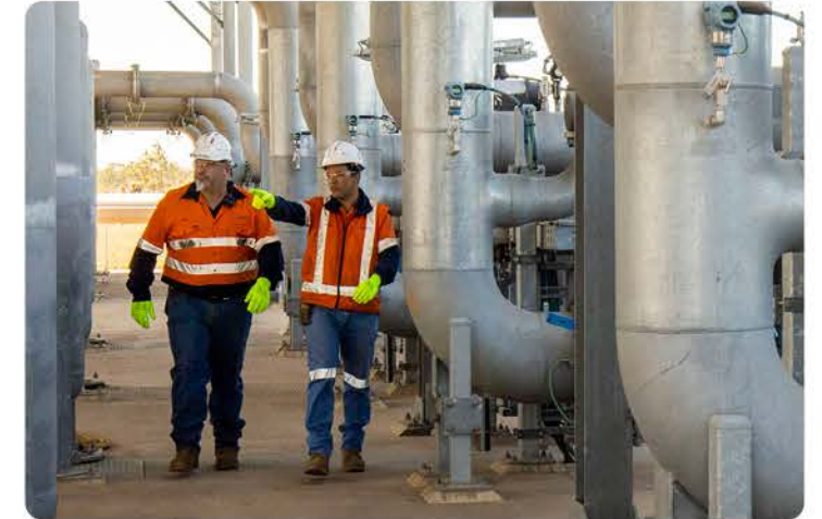
Planta de gas en Grosvenor. Cerca del 60% del gas metano de nuestras minas de carbón subterráneas se captura y luego se aporta a la red eléctrica de Queensland.
