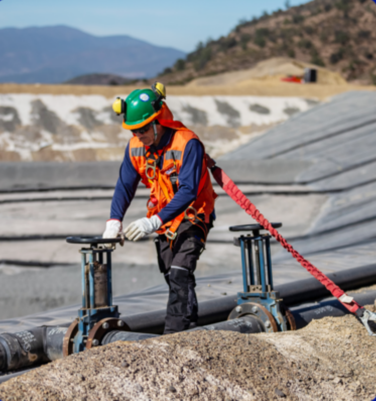
José Salazar, especialista en cumplimiento, revisa las válvulas en la planta piloto de apilamiento hidráulico seco (HDS) de El Soldado.
