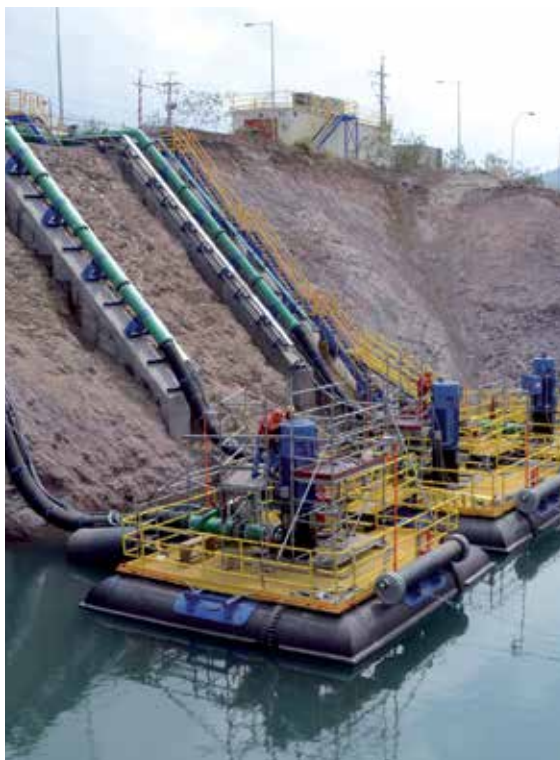
Sistema de recirculación de agua de Los Bronces.
